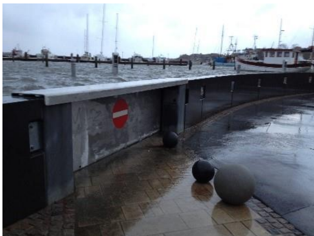
Figur 4-22 Skydeporten ved stormflod i Lemvig set fra landsiden under en stormflod.
